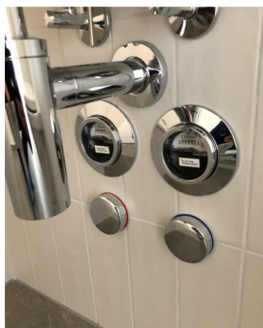
Compteurs et vannes
