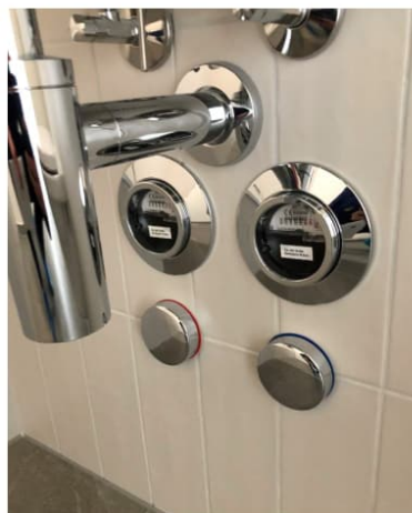
Compteurs et vannes
